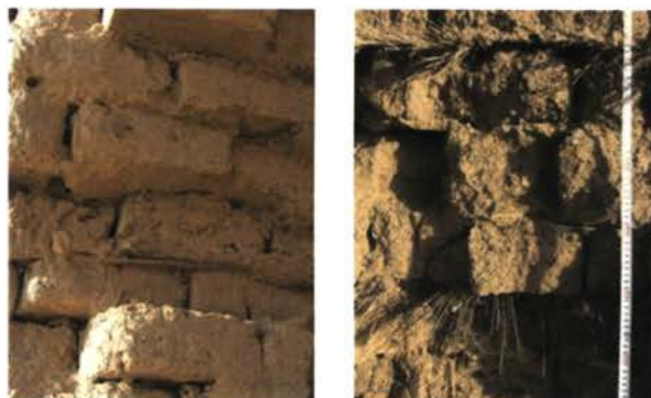
写真2 レンガの積み方 (左: T74 の南壁を側面から。右: A8 の北壁)
